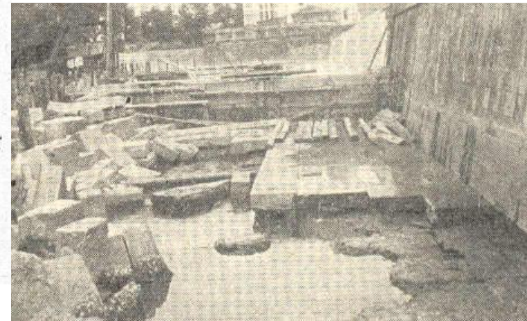
Poškození dna vývaru po povodni v roce 1940
