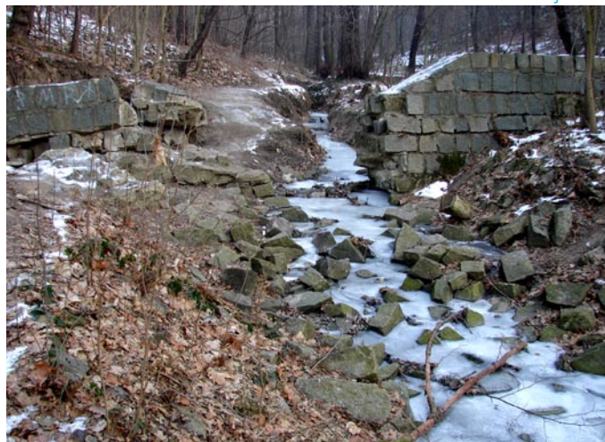
Zátišský potok – do vodoteče jsou zaústěny dvě dešťové kanalizace DN 1000. Při dešťových událostech je koryto neúměrně namáháno. Zdroj: Vlastní
