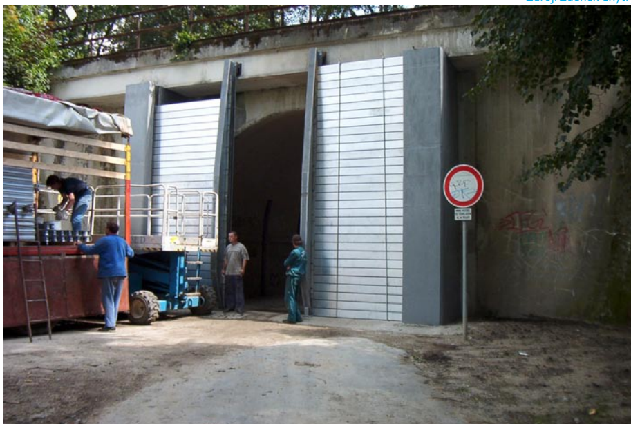
V případě povodně se uzavírají průchody pod tratí. Zdroj: Zdeněk Chytrý
