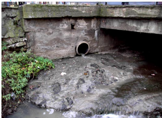
Zaústění splaškové kanalizace do vodního toku Řeporyje. Zdroj: Vlastní
