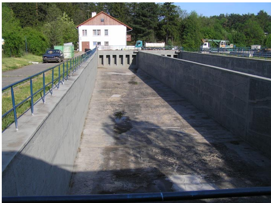
Retenční nádrž Řepy I bez hladiny stálého nadržení se svislými betonovými zdmi. Zdroj: Vlastní
