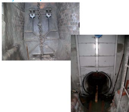
Pevný uzávěr na kanalizační síti, zpětná klapka. Zdroj: Archiv PVS, a. s.
