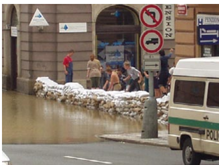
Při povodni v roce 2002 došlo i na výstavbu protipovodňových zátarasů – ve Zborovské ulici se stavěly z pytlů s pískem. Zdroj: Zdeněk Chytrý
