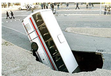
Propad vozovky v Lisabonu v roce 2004 způsobený přivalovým deštěm. Zdroj: Sky News
